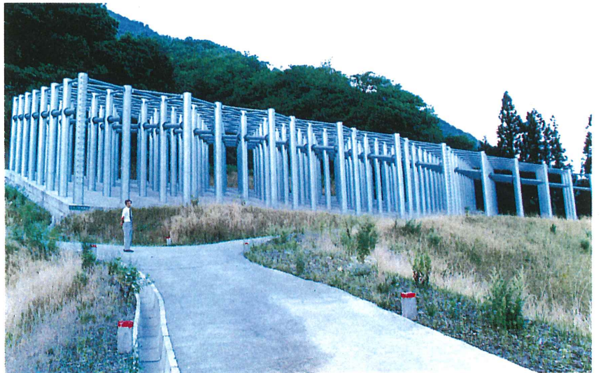
新潟県六日町地内に設置された雪崩減勢杭
