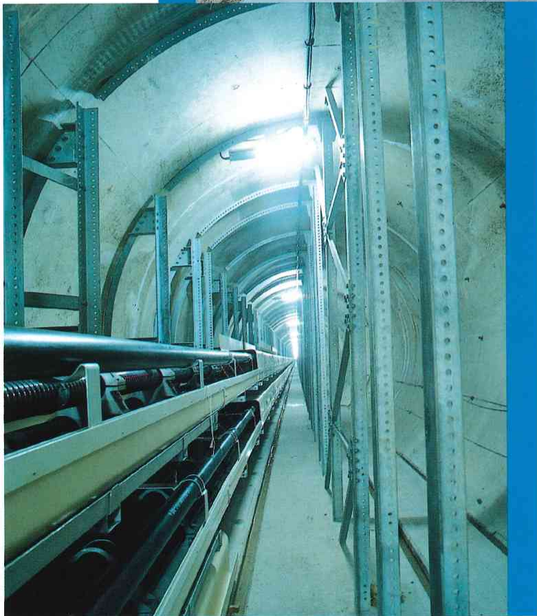
▲都市整備における地中線電気設備
