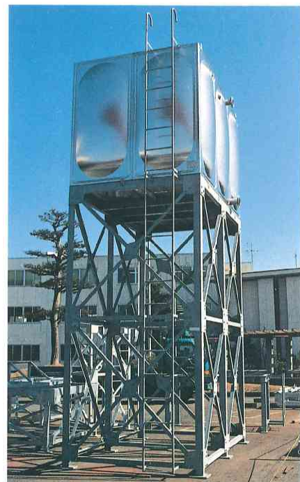
屋外タンク架台
