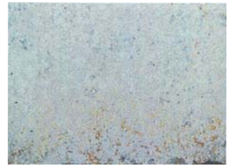
写真12 合金層腐食の事例
