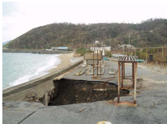
写真 2 陥没状況写真
